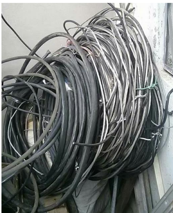
Figura 7. Cables del tendido eléctrico.
