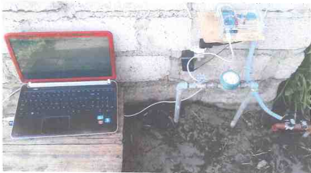
Figura 34 Imagen del prototipo implementado en la red de agua potable
