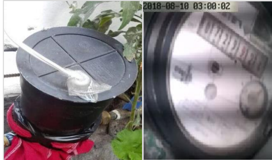
Figura 20: Cámara de video instalada en el micro medidor
