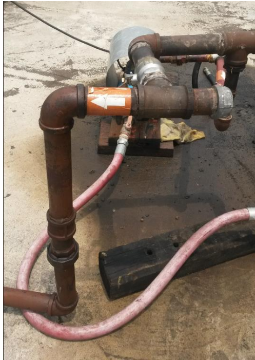
Figura 118 Fuga de combustible Elaborado por: El investigador
