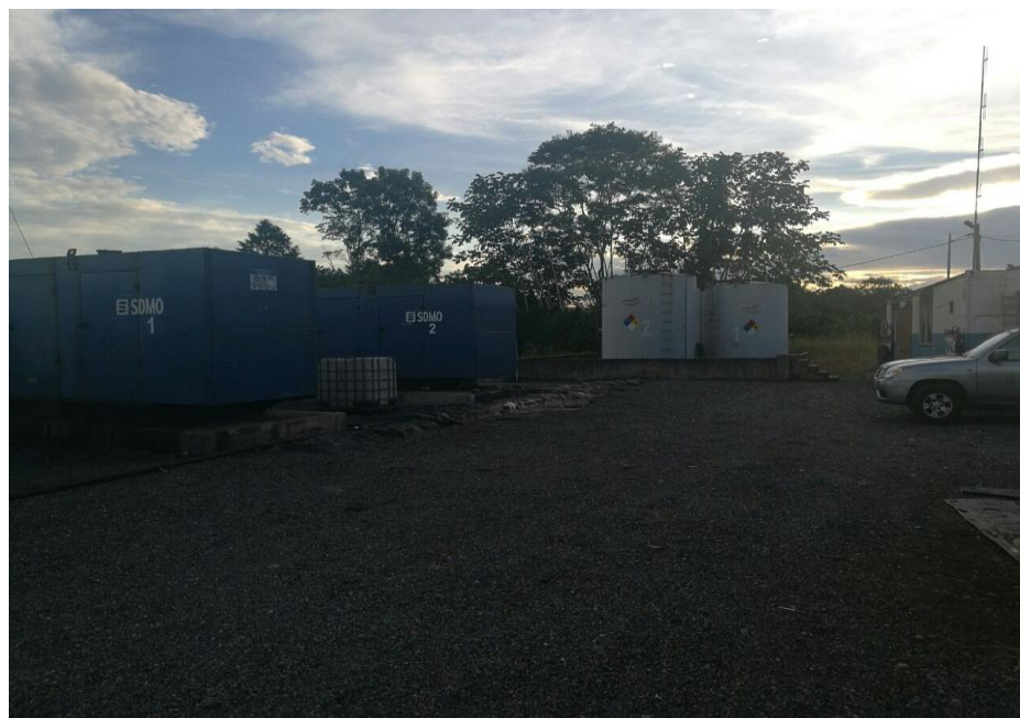
Figura 116 Fotografía de la central térmica Loreto
