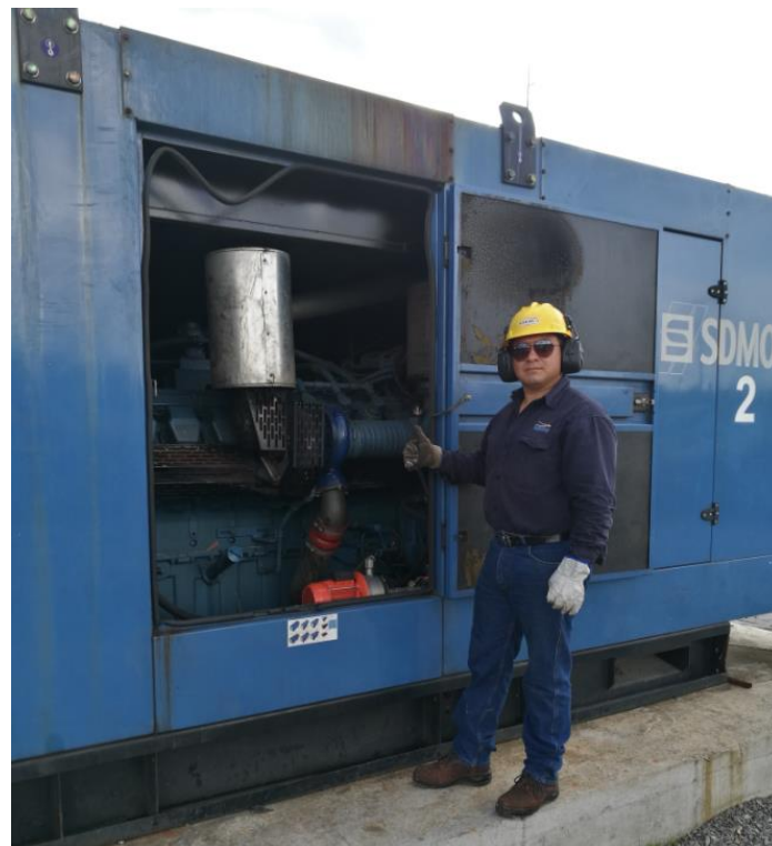
Figura 123 Unidad de generación
