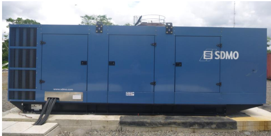
Figura 8 Grupo electrógeno SDMO
