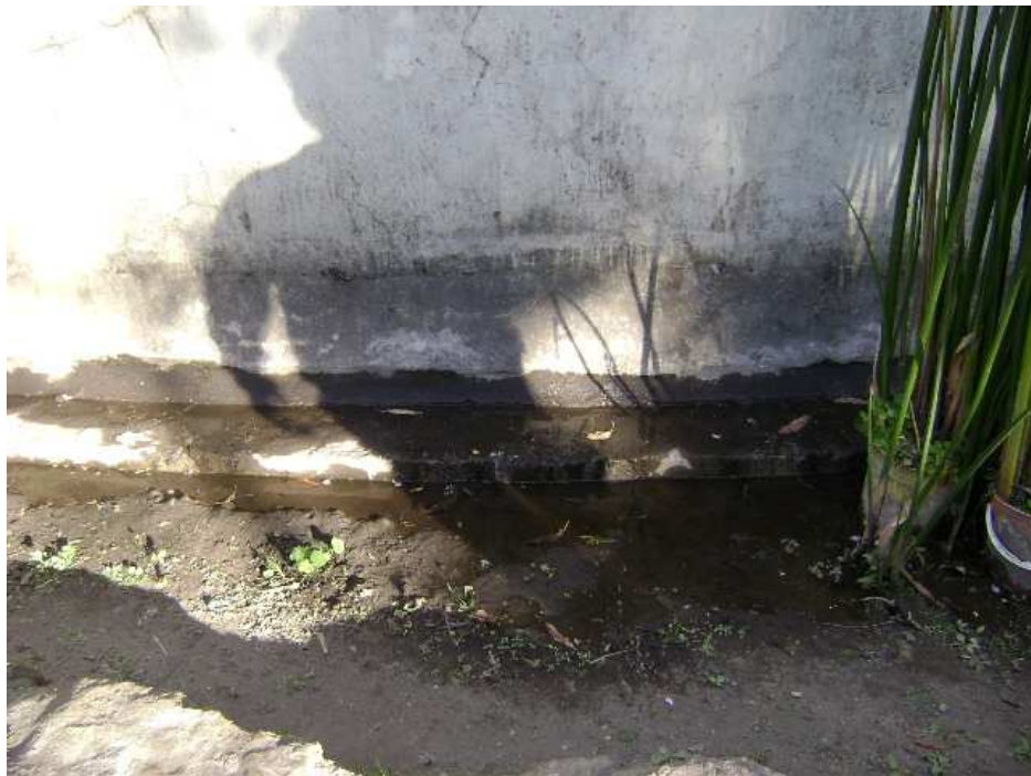
Fotografía N° 4: Filtraciones de agua en la junta del tanque de la Saboya
