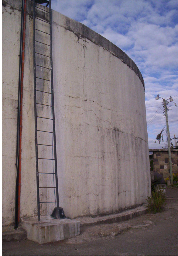
Fotografía N° 3: Tanque de almacenamiento de 2000 m3. Reserva de la Saboya
