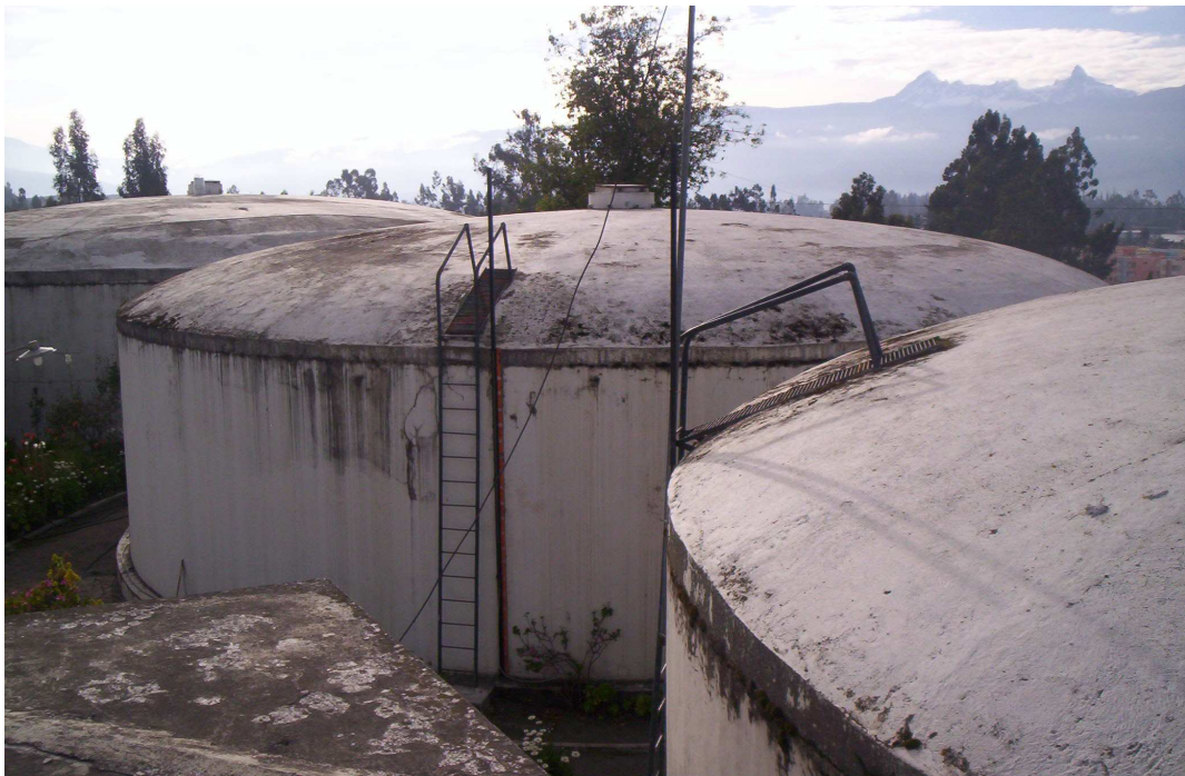
Fotografía N° 2: Tanque de almacenamiento de 2000 m3. Reserva de la Saboya
