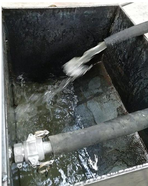
Figura 81: Prueba de la bomba peristáltica realizada con agua
