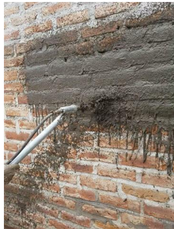
Figura 88: Prueba de funcionamiento de la máquina revocadora de mortero en una superficie
