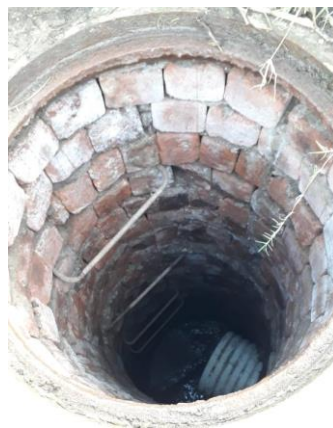
Figura 7. Pozo de revisión de la celda emergente 1 y 2
