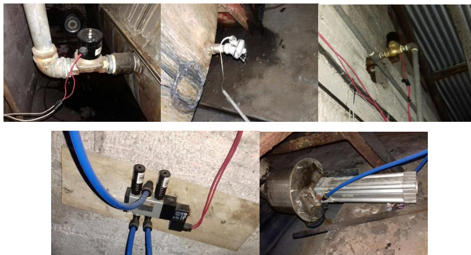
Fig. 4.55. Colocación de sensores y actuadores. Elaborado por: Investigador
