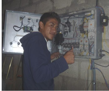
Figura 127. Montaje del tablero de control
