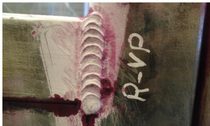
Figura 9. Junta soldada evaluada con tintas penetrantes lavable en disolvente Fuente: El autor
