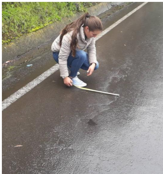
Descripción: Registro de las fallas existentes en la capa de rodadura.
