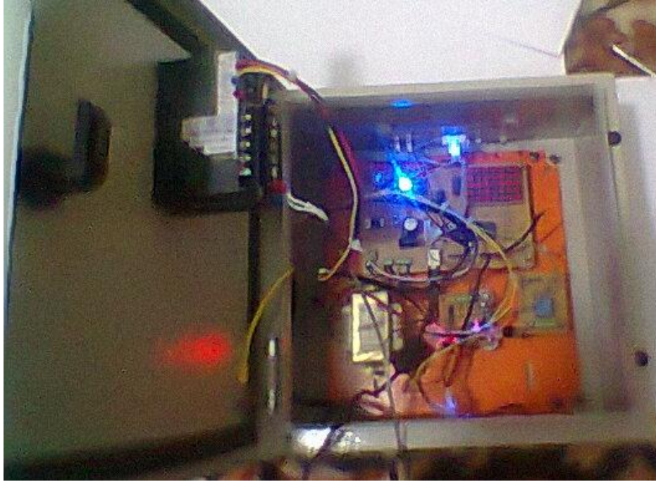
Figura 6. 44. Funcionamiento del sistema electrónico de control (interior) Elaborado por el investigador
