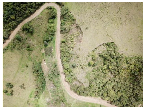
Anexo 28B. Estado de la vía actual tomada desde el dron en el tramo Km 27+000
