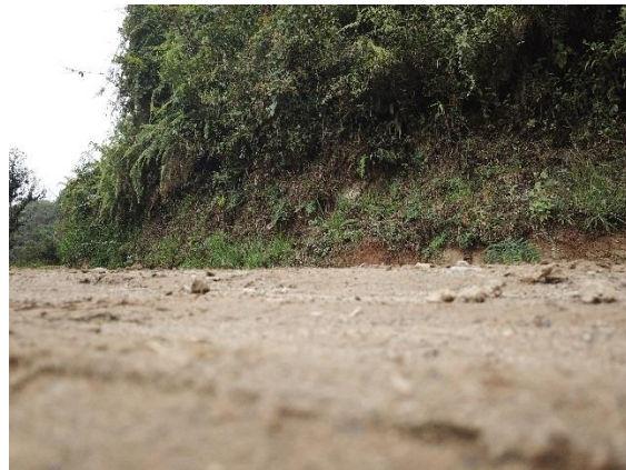
Anexo 22B. Estado de la vía actual
