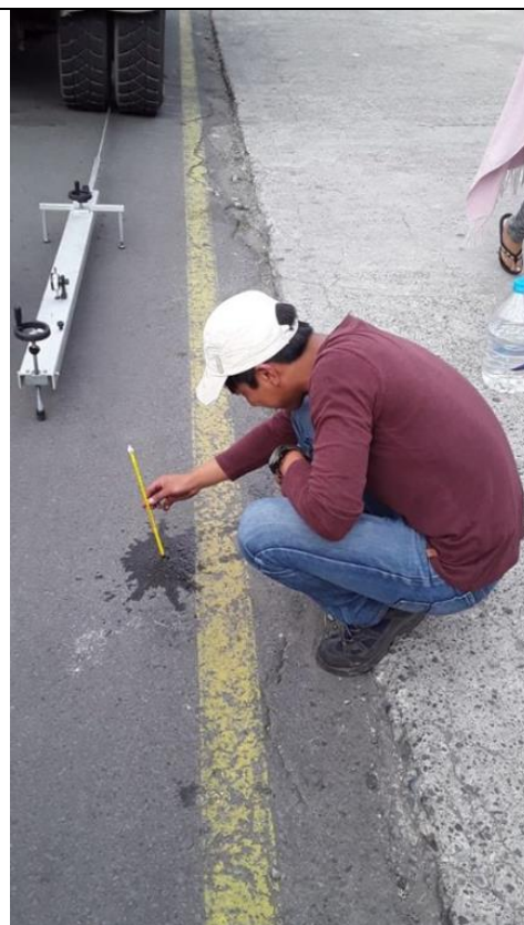
Descripción: Colocación del termómetro en la perforación de la capa de rodadura para medir su temperatura
