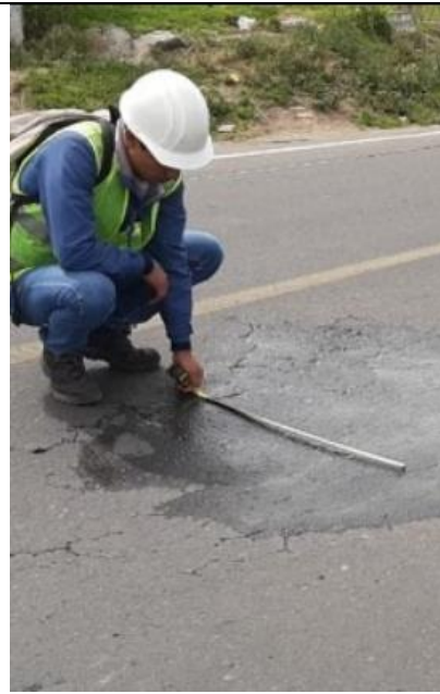
Descripción: Medición de la falla de depreciación en la carpeta asfáltica
