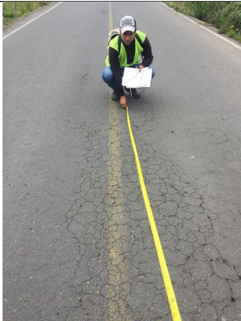
Descripción: Medición de la falla de piel de cocodrilo en la carpeta asfáltica
