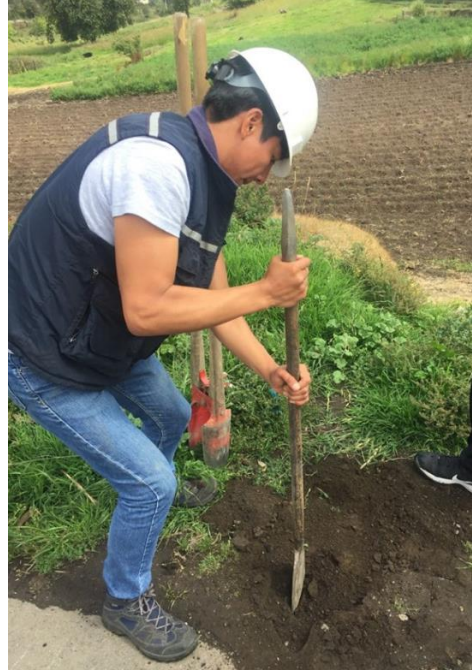
Descripción: Ejecución del pozo a cielo abierto, para extraer las muestras del suelo
