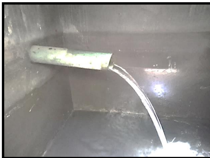
Gráfico N° 31. Tubería PVC de 110.00 mm en la captación.
