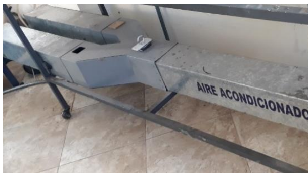
Figura 3. 10 Ductos de aire. [Autor]
