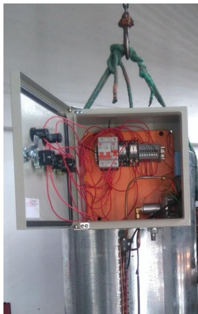
Figura 48. Proceso de automatización de la caldera GN.1001 – LTJ
