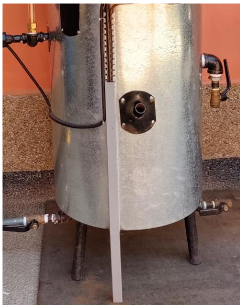
Figura 46. Canaleta ranurada, cables de alta tensión y cañerías de transporte de GLP
