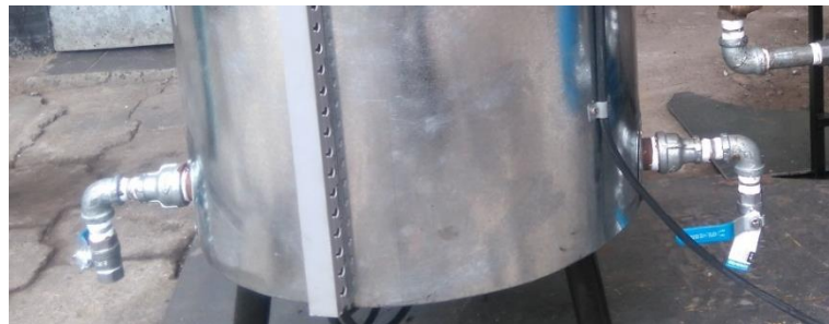
Figura 38. Válvulas de purga de la caldera
