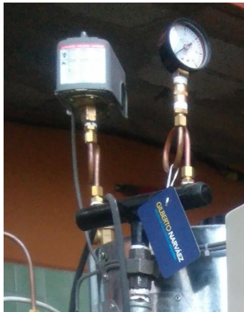
Figura 41. Manifold, tubos sifones, presostato y manómetro
