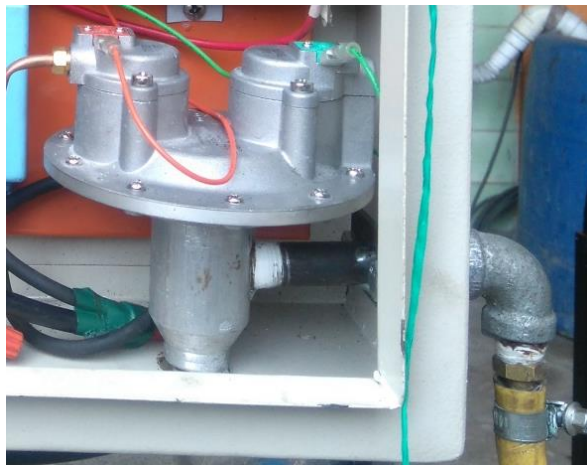
Figura 45. Válvula de gas con bobinas acoplada a gabinete eléctrico
