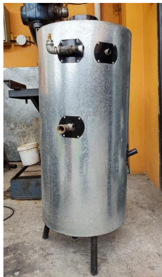
Figura 35. Estructura de la caldera con aislamiento térmico total
