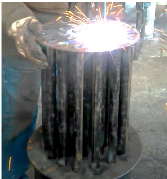
Figura 19. Cámara de tubos o haz tubular de caldera GN.1001 – LTJ
