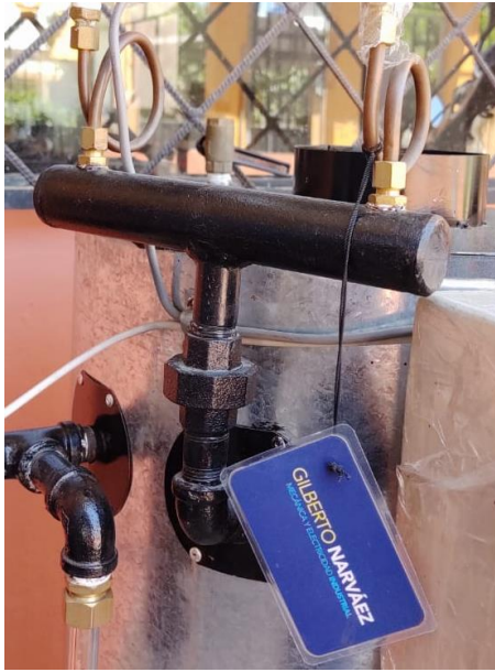
Figura 40. Manifold con colitas de chancho
