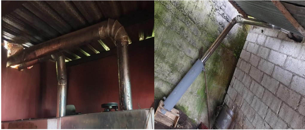
Figura 36.- Chimenea del horno [Autor]
