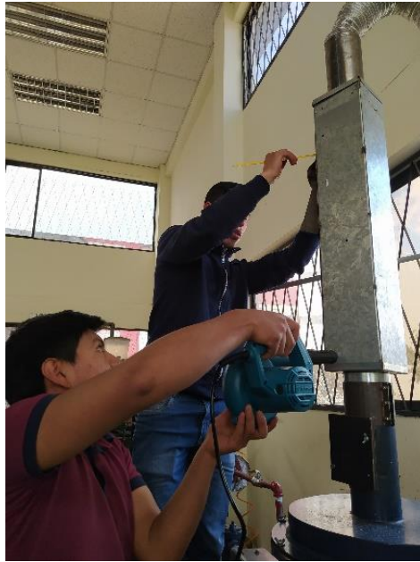
Figura 34.- Colocación de ventilador y termómetro [Autor]
