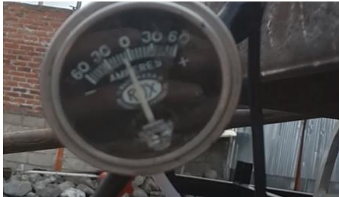
Figura 74. Amperaje obtenido en prueba del sistema de generación.
