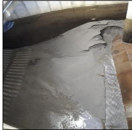
Figura 26. Desripiador lleno de sedimentos pétreos antes de su limpieza Elaborado por: El Investigador.
