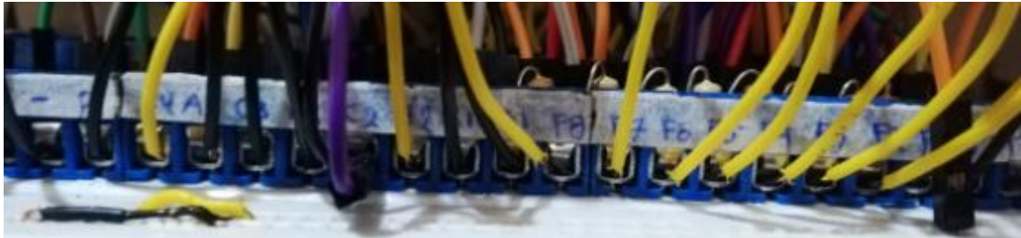
Figura 108. Conexiones en borneras para el prototipo de monitoreo y control de las compuertas de purga.
