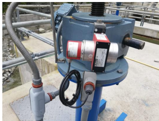
Figura 35. Encorder ubicado en estructura de compuerta de ingreso de agua hacia la tubería de conducción.
