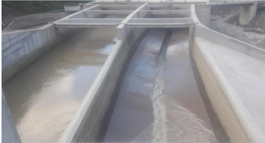
Figura 29. Cámaras desarenadoras en sistema de captación de agua de la central Río Verde Chico.
