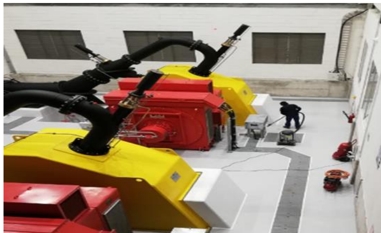
Figura 39. Vista superior de unidades de generación marca WKV en la central hidroeléctrica Río Verde Chico.
