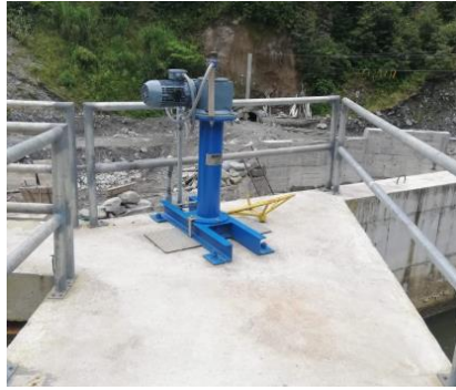
Figura 36. Estructura de apertura y cierre de compuerta de purga del tanque de carga.
