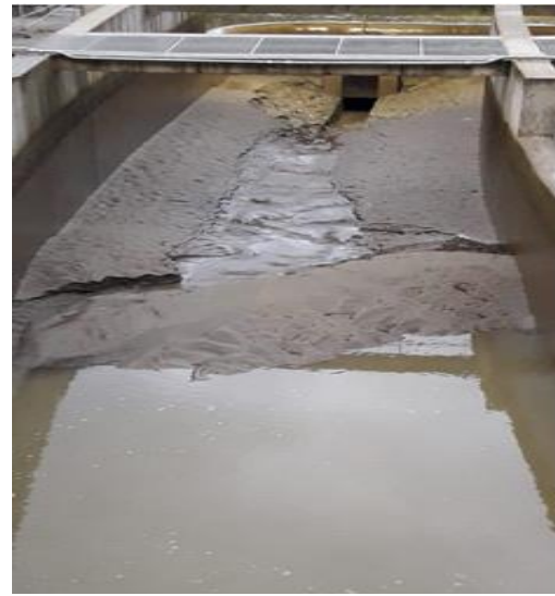
Figura 30. Cámara desarenadora antes de ser lavada.
