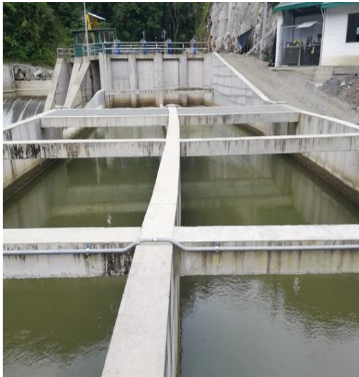
Figura 31. Desarenadores en funcionamiento normal.
