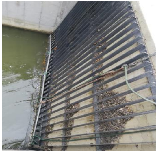
Figura 23. Vista de rejilla principal de entrada desde la loza del sistema de captación de agua.
