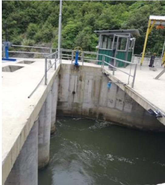
Figura 25. Cámara deslupadora en funcionamiento normal en el sistema de captación de agua de la central hidroeléctrica Río Verde Chico.
