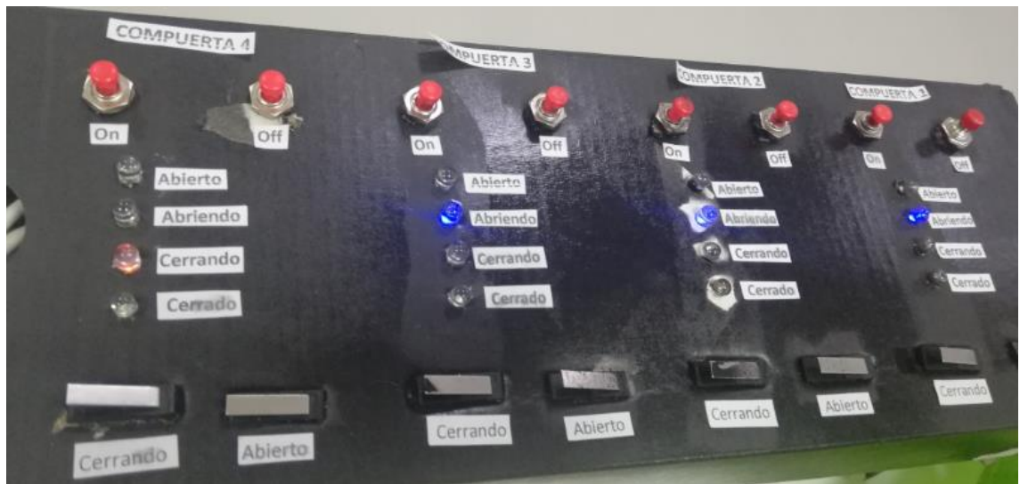
Figura 119. Compuerta 1, 2, 3, con señal de apertura y compuerta 4 con señal de cierre.
