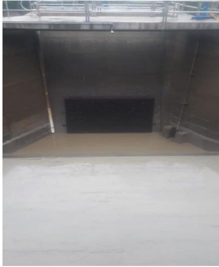
Figura 33. Tanque de carga del sistema de captación de agua de la central hidroeléctrica Río Verde Chico.
