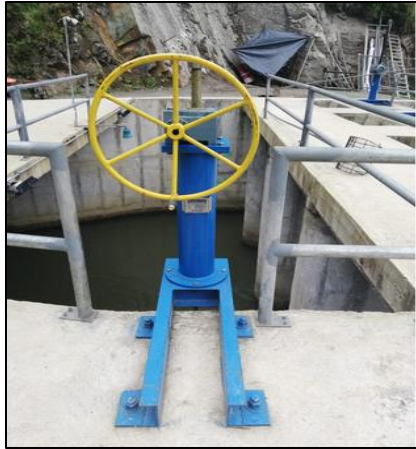
Figura 27. Volante de apertura y cierre de compuerta manual de purga del Desripiador Elaborado por: El Investigador
