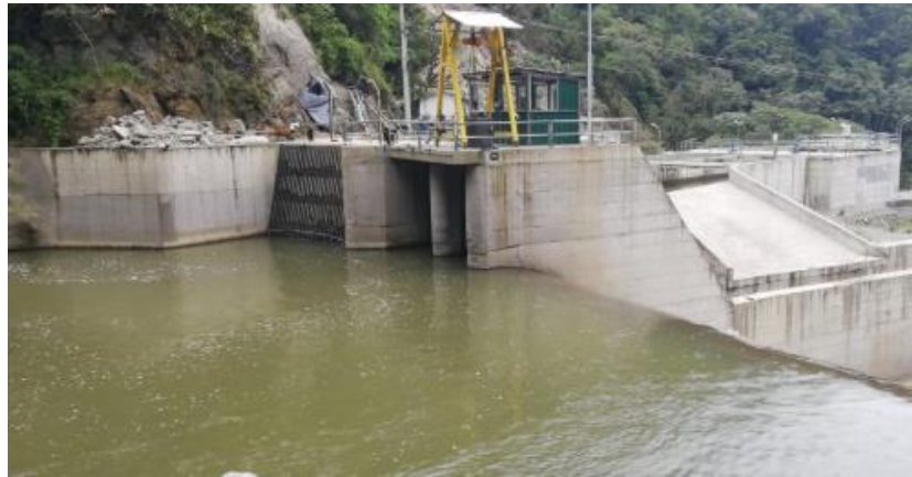
Figura 22. Rejilla de entrada principal.
