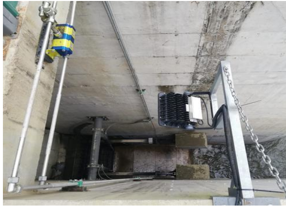
Figura 19. Vista superior de compuerta radial 2
