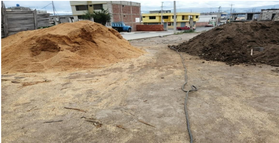
Figura 10: Deposito de materiales
