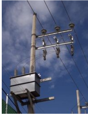
Figura 1.2.5. Transformador final a 127 V C.A.
