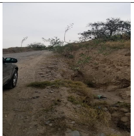
Estado actual de las cunetas
