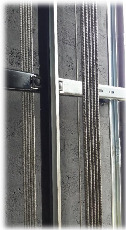
Figura 41. Cables de tracción.
