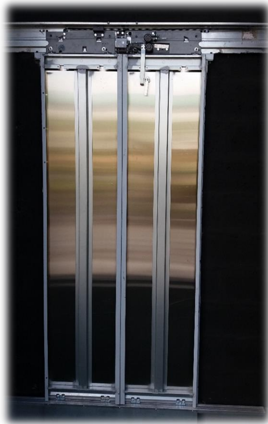
Figura 44. Puertas pasillo del ascensor.
