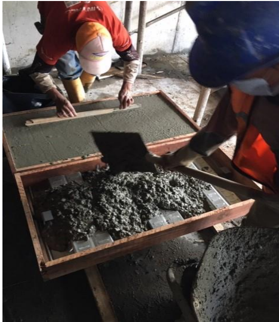
Gráfico 34 Vertido de hormigón en cada uno de los tipos para el ensayo
