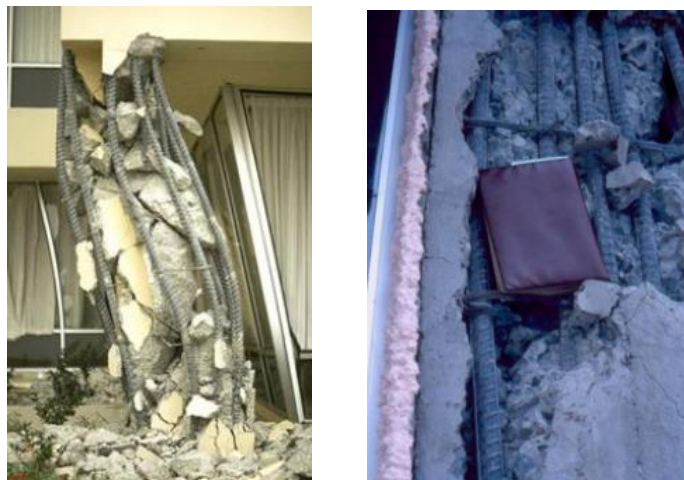
Figura 6: Falla por insuficiente confinamiento en columna y viga
