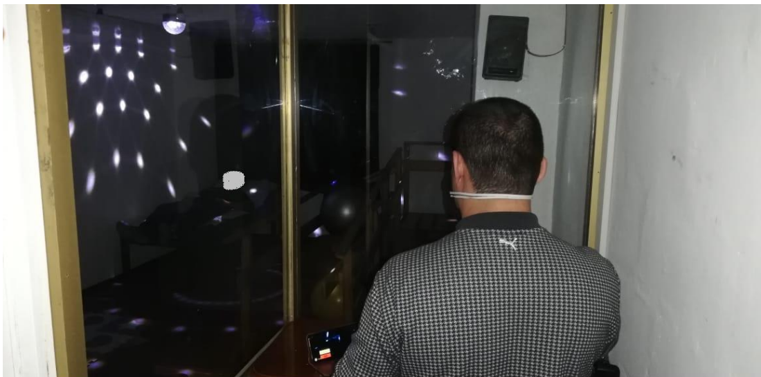
Figura 65: Pruebas del sistema de iluminación
