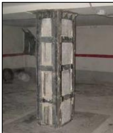
Figura N° 27: Columna con platinas metálicas ángulos de reforzamiento
