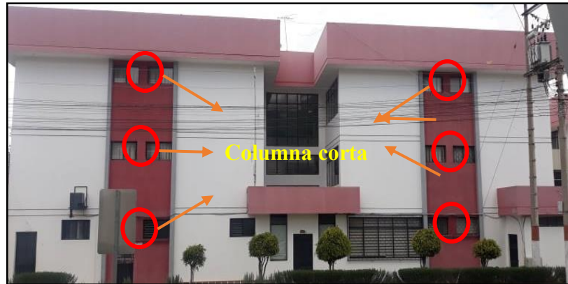
Figura N° 50: Columna corta en la estructura
