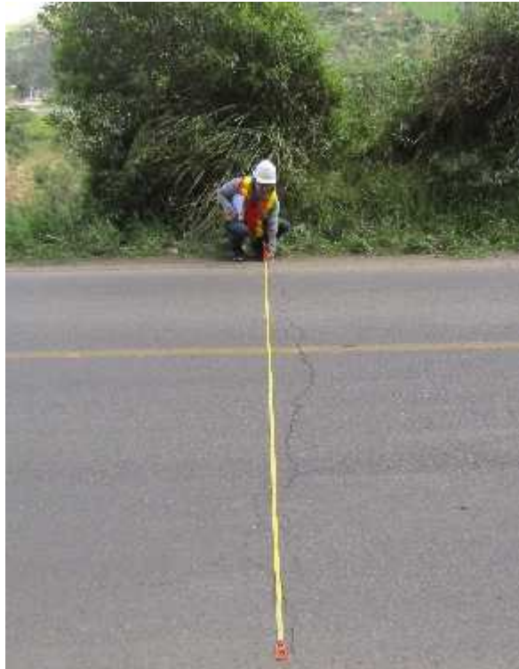
Figura 78: Fisuras longitudinales y transversales
