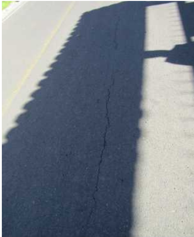
Figura 81: Fisuras longitudinales y transversales
