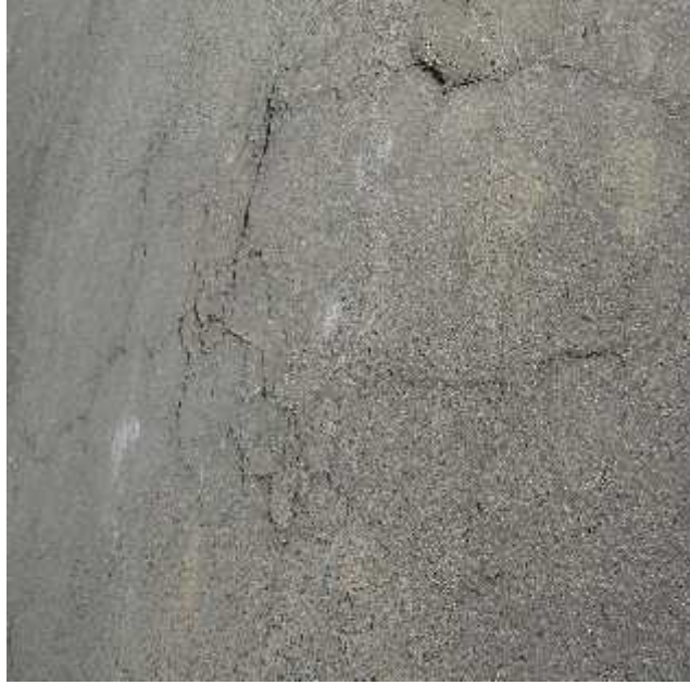
Figura 80: Fisuras en bloque
