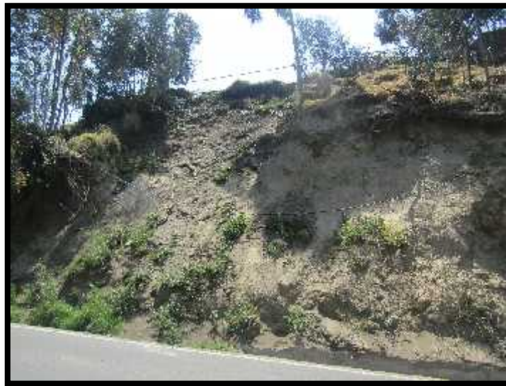
Figura 8: Condición actual del talud en la abscisa km 1+680 vía Quero – Puñachizag
