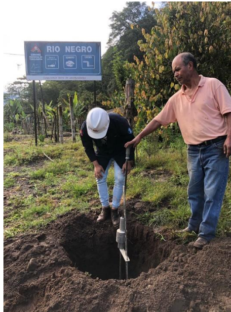
Figura 32: Realización del ensayo DCP en el interior del pozo a cielo abierto. Autor: José Luis López Sánchez.
