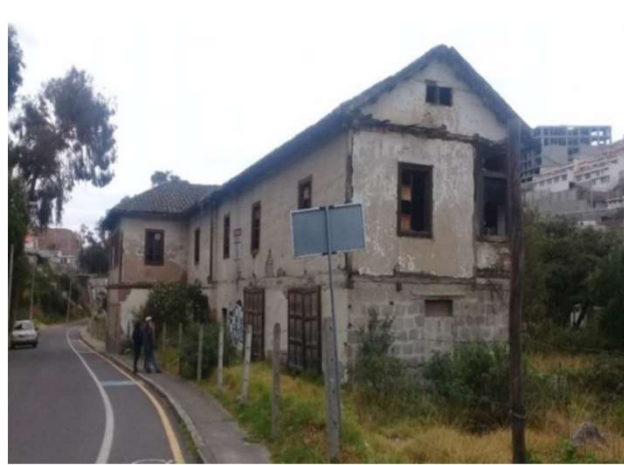
Tramos de losa y estructura de madera, destruidas con piezas faltantes, enlucidos viejos y desprendidos de muros portantes de piedra, tabiques de bahareque en ruina
