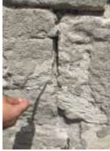
Ilustración 47: Ejemplo patología "El Peral"
