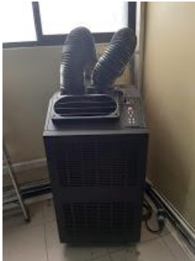
Figura 25. Ventilador en el cuarto de servidores de la Unidad de Gestión Tecnológica
