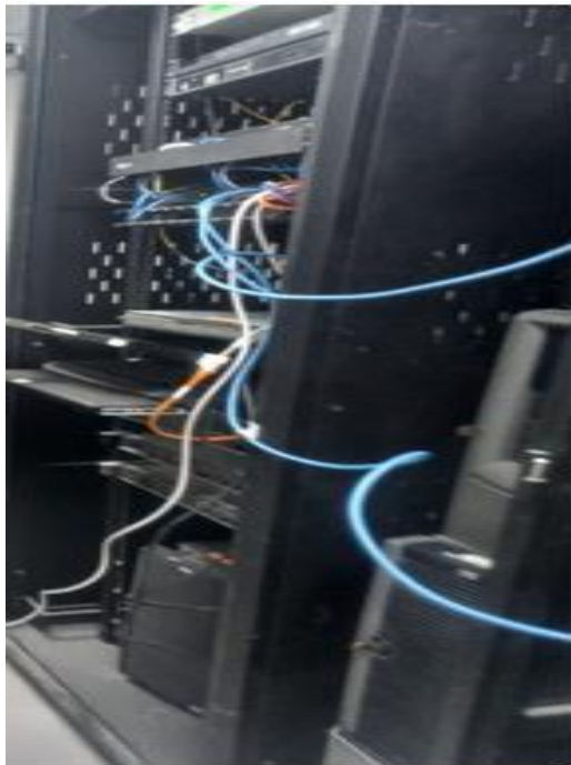
Figura 41. Cuarto de servidores
