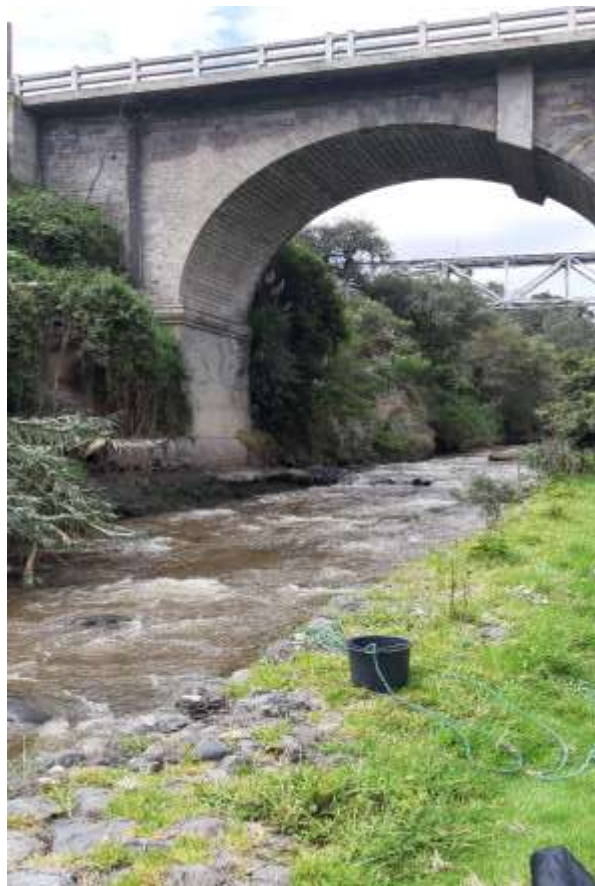
Fase 2 Punto 7: Socavón
