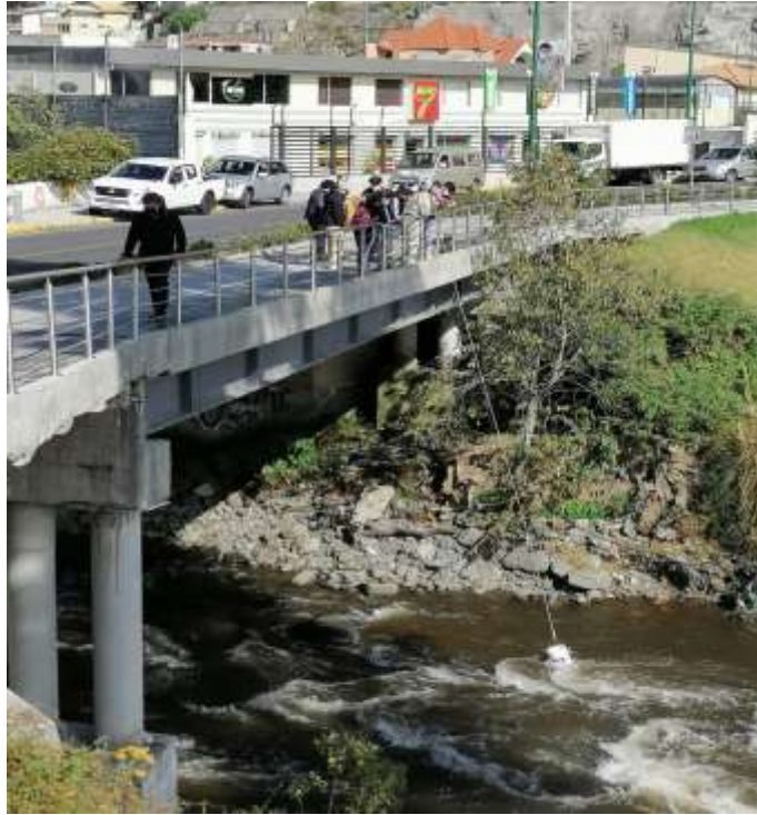
Fase 1 Punto 7: Socavón
