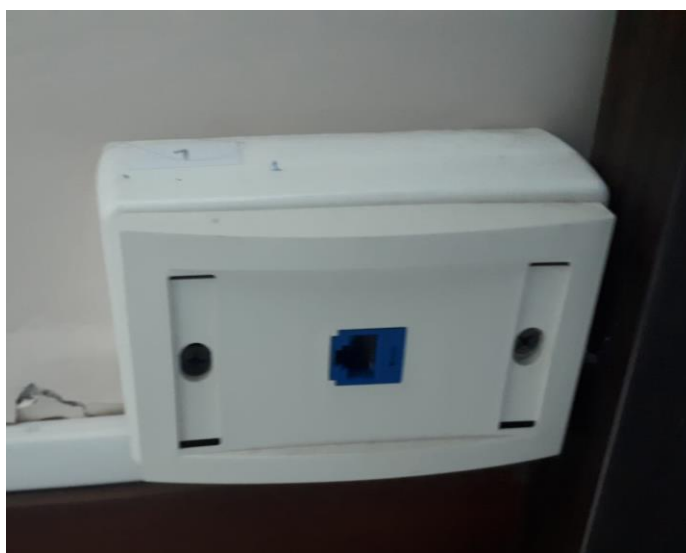
Figura 4.3: Infraestructura de la red de datos del Edificio Mayorga Puerres
