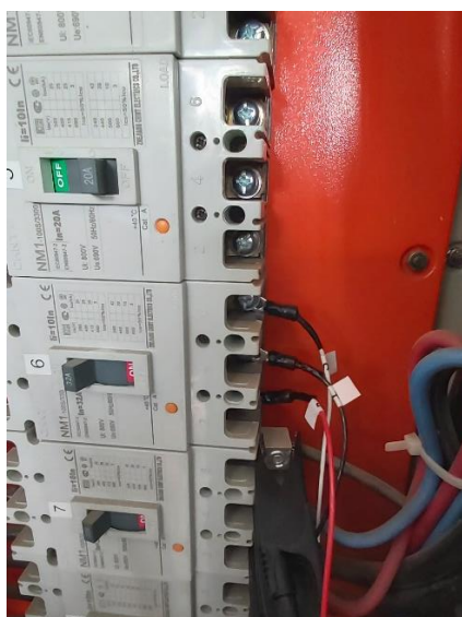
Figura 4.36: Tablero de breaker TDP y conectividad del equipo
