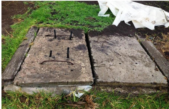
Imagen 36 Caja de Revisión – Planta de Tratamiento de Aguas Residuales Chambiato
