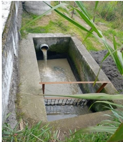
Imagen 30 Cribas de Salida– Planta de Tratamiento de Aguas Residuales Chambiato
