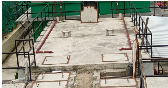
Imagen 43 Sedimentador Primario– Planta de Tratamiento de Aguas Residuales La Rabija
