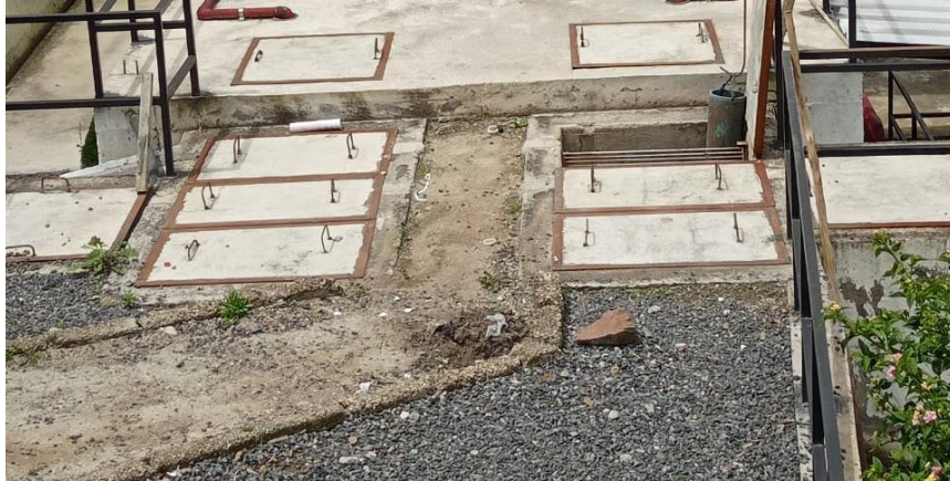
Imagen 42 Pretratamiento - Planta de Tratamiento de Aguas Residuales La Rabija
