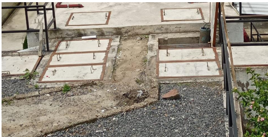
Imagen 49 Caja de Revisión – Planta de Tratamiento de Aguas Residuales La Rabija
