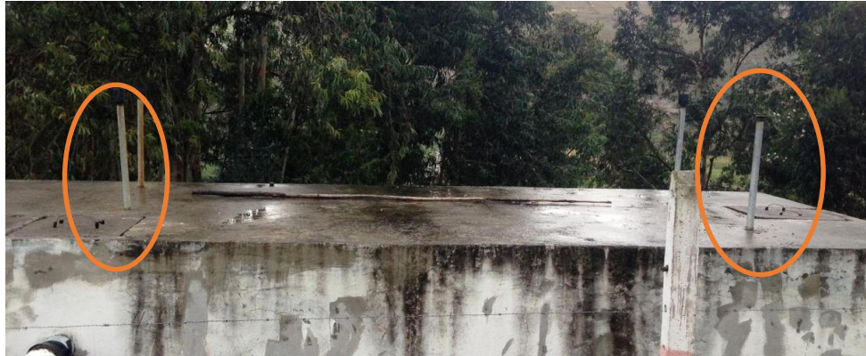
Imagen 39 Chimeneas del Tanque IMHOFF – Planta de Tratamiento de Aguas Residuales Chambiato
