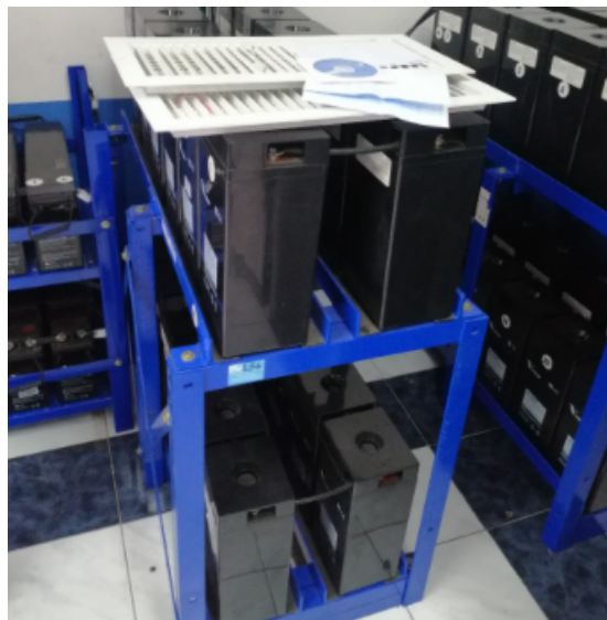
Banco de Baterías Estacionarias
