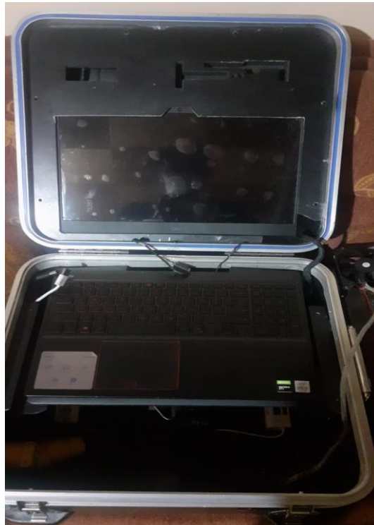
Ilustración 60 Verificación de conexiones Centro de mando y control.
