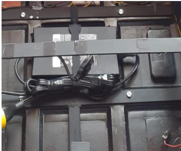
Ilustración 52 Ubicación de la batería.
