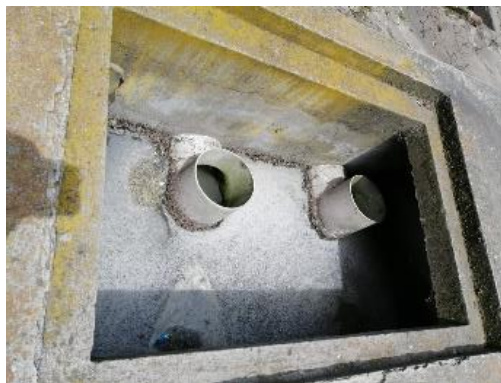
Figura 38. Desarenador PTAR cantón Cevallos
