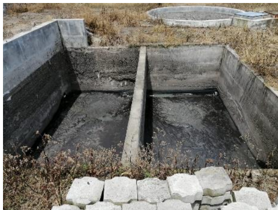
Figura 42. Lecho de secado de lodos PTAR cantón Cevallos
