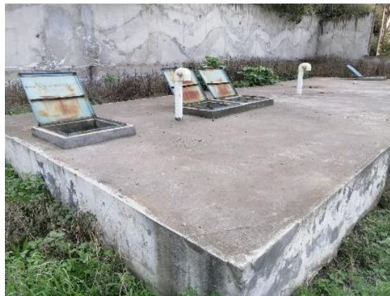
Figura 40. Sedimentador Secundario PTAR cantón Cevallos
