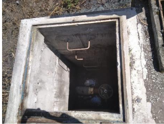
Figura 43. Tanques de protección PTAR cantón Cevallos
