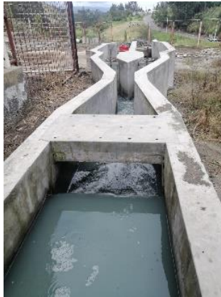
Figura 37. Parshall de ingreso PTAR cantón Cevallos
