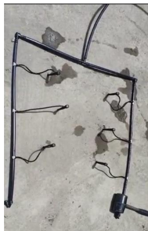
Figura 2-14 Sistema de Aspersión de Agua
