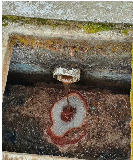
Figura 21. Interior del tanque séptico de la PTAR.
