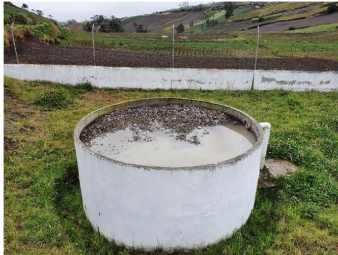
Figura 22. Filtro biológico ascendente de la PTAR.
