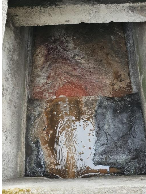
Figura 18. Tanque repartidor de la PTAR.
