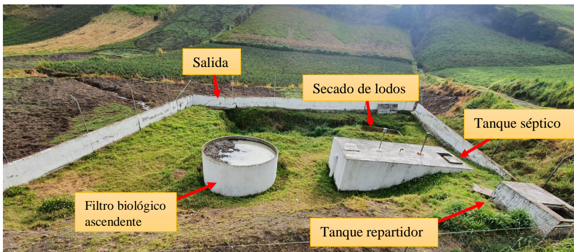
Figura 8. PTAR comunidad Hualcanga San Luis.
