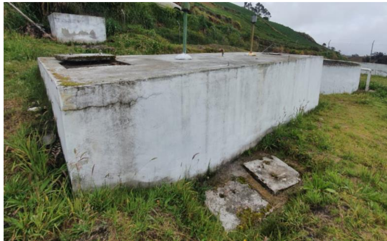
Figura 19. Tanque séptico de la PTAR.
