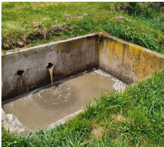
Figura 23. Lecho de secado de lodos de la PTAR.
