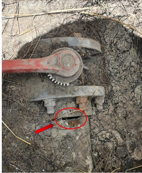
Figura 20. Unión desde la llave de paso del tanque séptico roto.
