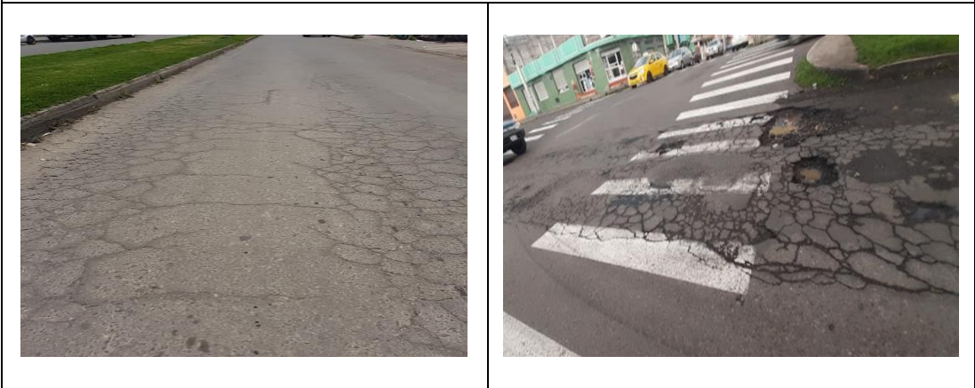
Fallas encontradas en la vía para el análisis PCI
