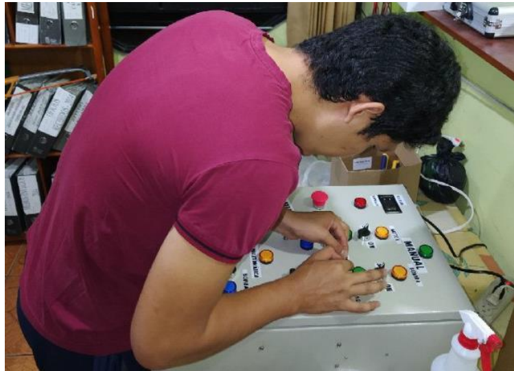
Figura 57 Rotulación tablero de control
