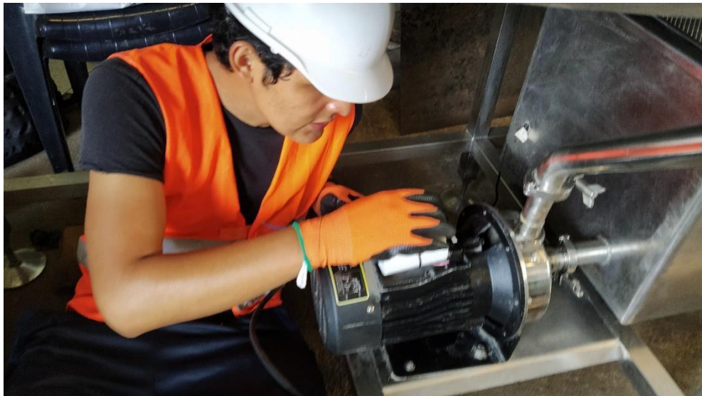
Figura 25 Mantenimiento de la bomba
