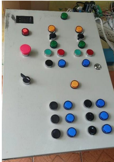
Figura 51 Tablero de control
