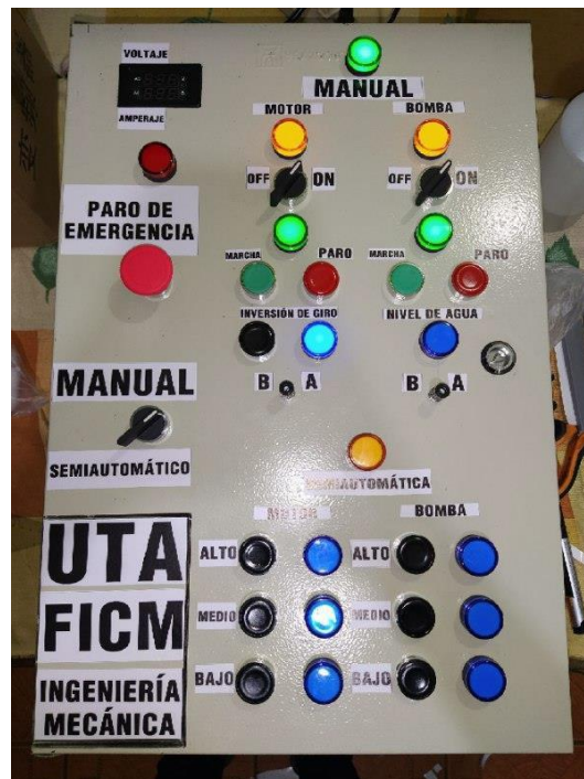
Figura 58 Tablero de control rotulado
