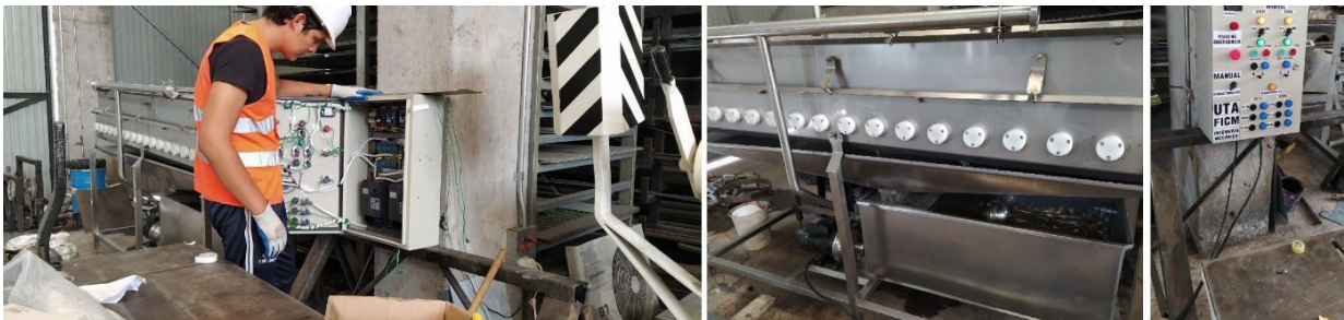
Figura 60 Conexión máquina-tablero de control
