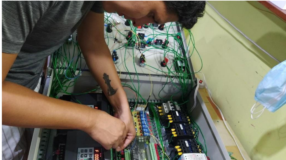
Figura 55 Comprobación de energía en el tablero de control
