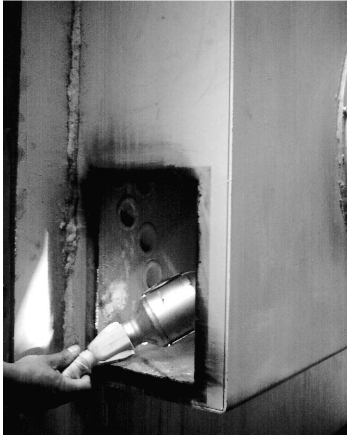
Foto 13: Vista posterior del caldero, retiradas las compuertas posteriores, es aquí donde se recoge el hollín desprendido de los tubos.
