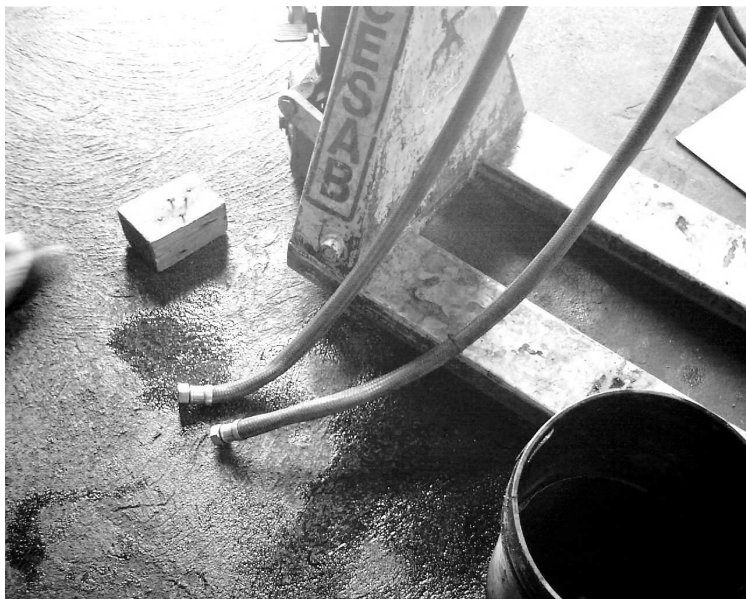
Foto 02: Tuberías de ingreso y retorno de combustible ya desconectadas.
