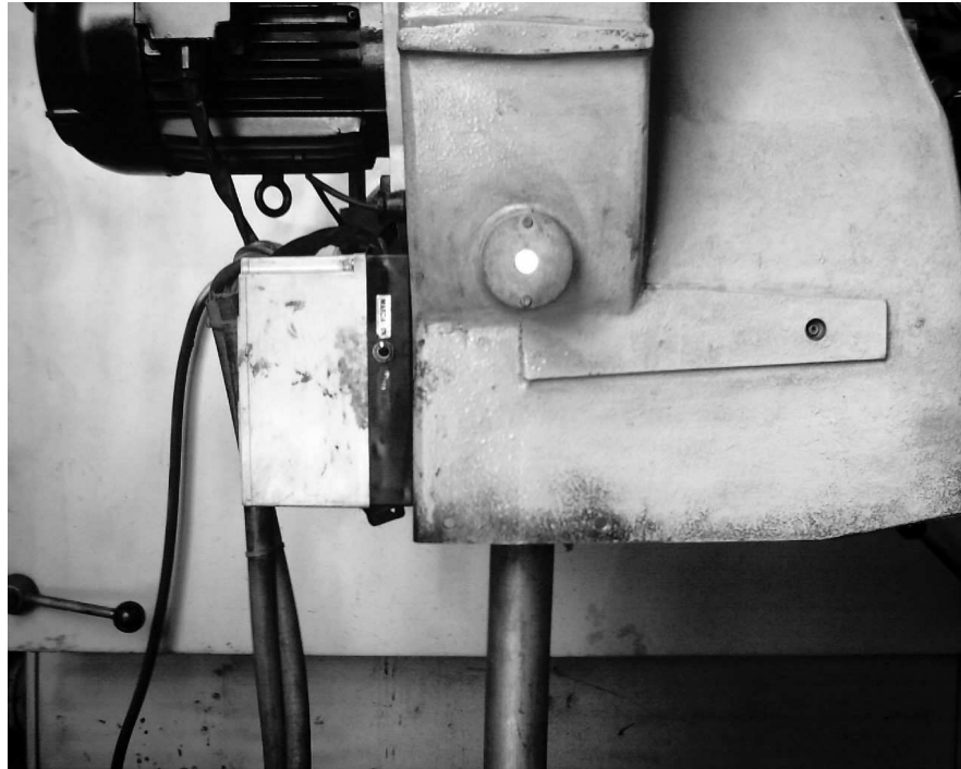
Foto 23: Luego del barrido actúa la válvula de fuego bajo, su finalidad es evitar explosiones, luego actúan las dos válvulas de fuego alto.
