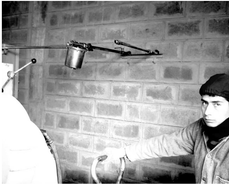
Foto 01: Luego de haber enfriado el caldero por un tiempo de 48 horas, se procede a desconectar: las tuberías de ingreso de ingreso y retorno de combustible.
