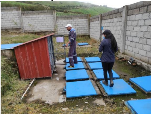
Fotografía 23: Recorrido por distribuidor de caudales
