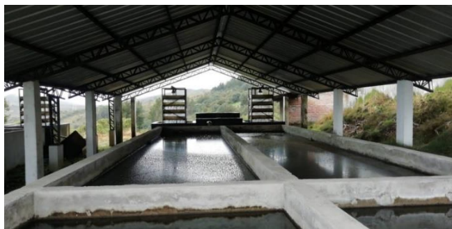
Figura 46. Planta de pre tratamiento - Aireadores y Sedimentadores
