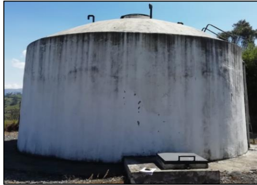
Figura 29. Tanque de reserva
