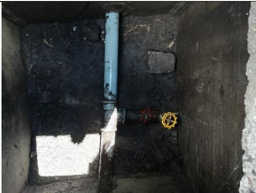
Fotografía 19: Válvula de desfogue - línea de conducción
