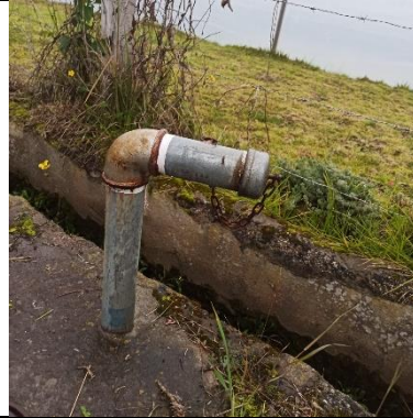
Fotografía 34: Boca de fuego
