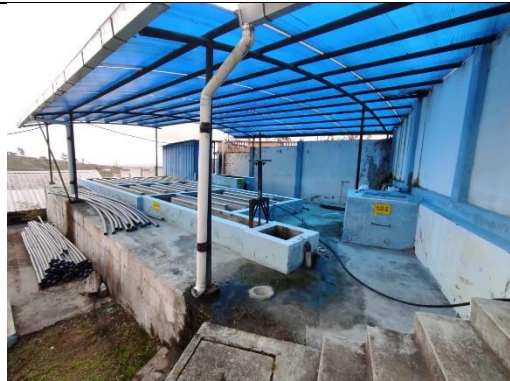
Fotografía 20: Planta de tratamiento “San Miguel” – Zona Norte
