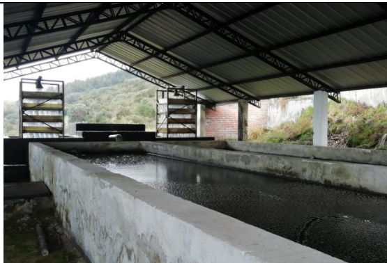
Fotografía 21: Planta de pre tratamiento – Sedimentadores y Aireadores
