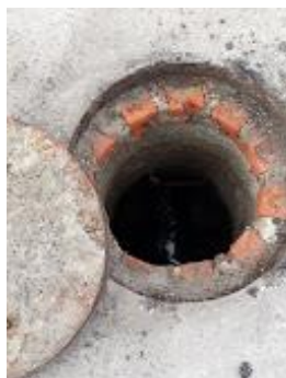
Figura 24. Pozo de revisión destapado.
