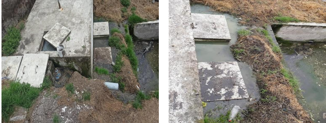
Figura 54. Estado actual del tanque séptico
