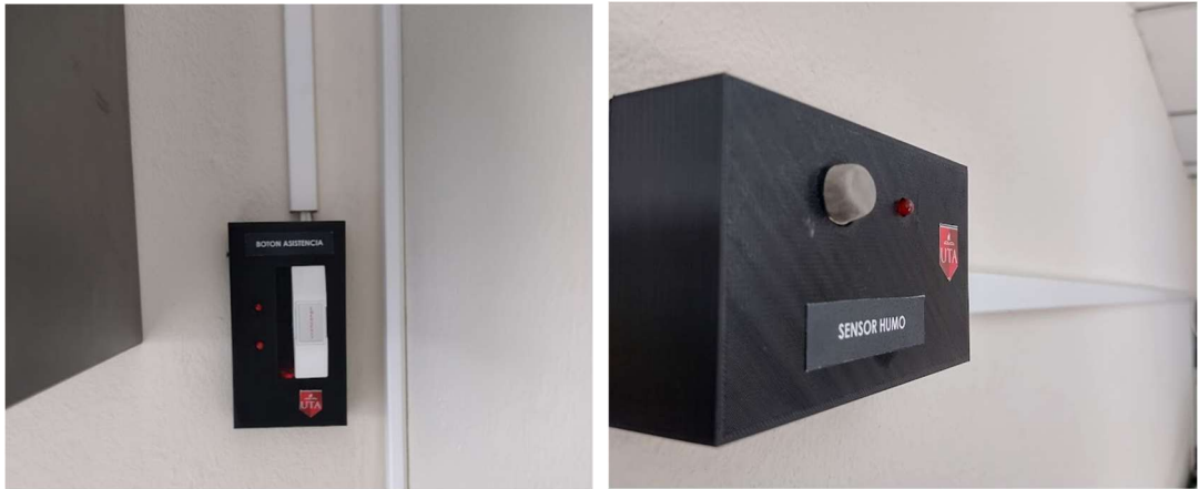
Figura 100. Módulos de Asistencia y detección de humo instalados Elaborado por: El Investigador
