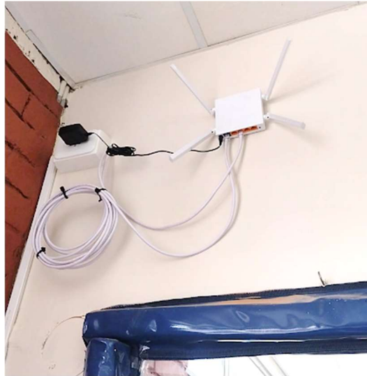
Figura 96. Instalación del Router Wifi en el área habitacional Elaborado por: El Investigador
