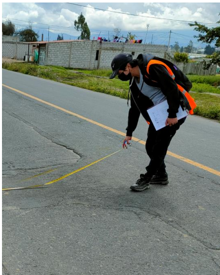
Fotografía 3: Registro de dimensiones de las fallas del pavimento.
