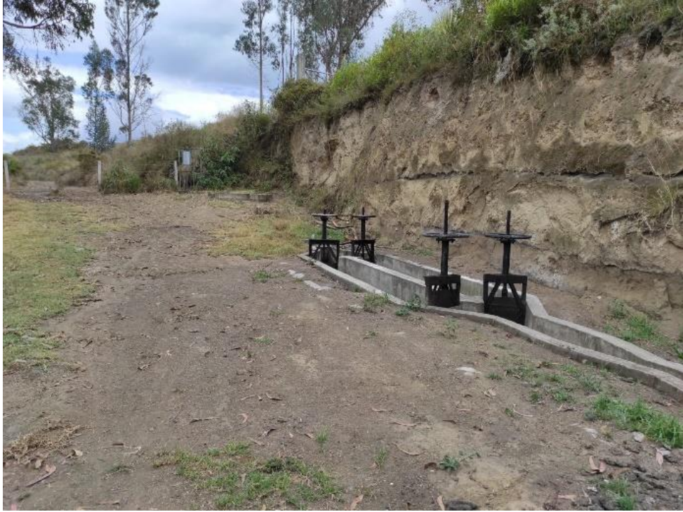
Figura 25 Ingreso de las aguas servidas a la PTAR "La Libertad"
