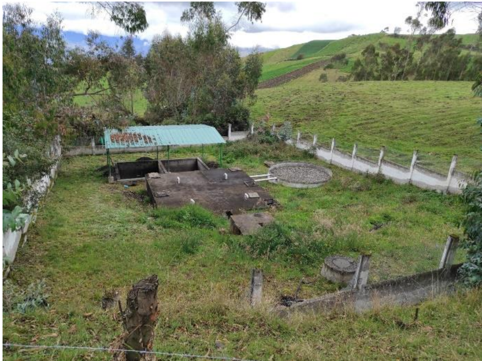
Figura 18 Planta de tratamiento de aguas residuales "Bellavista"
