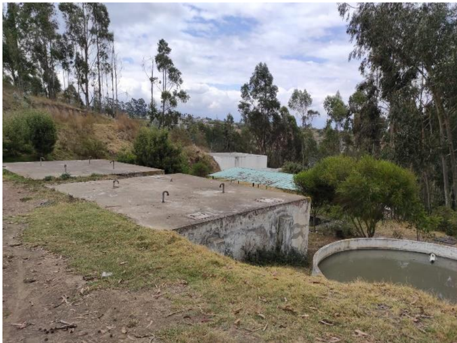
Figura 26 Planta de tratamiento de aguas residuales "La Libertad"
