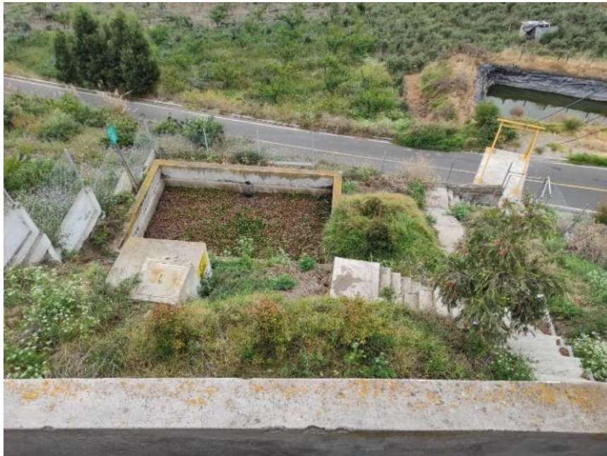
Figura 22 Tanque biodigestor - PTAR "Centro Cantonal"
