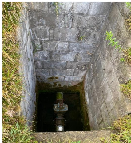
Ilustración 3. Válvula del tanque de Reservorio del barrio Bellavista. Fuente: Autores
