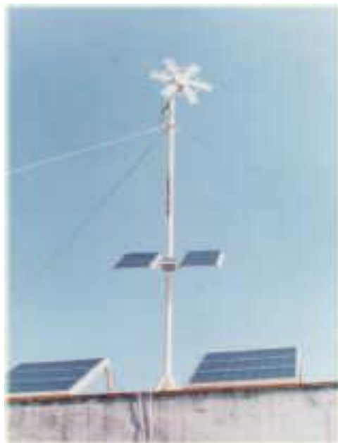
Fig. 2.9 Sistema de bombeo eólico – eléctrico.
